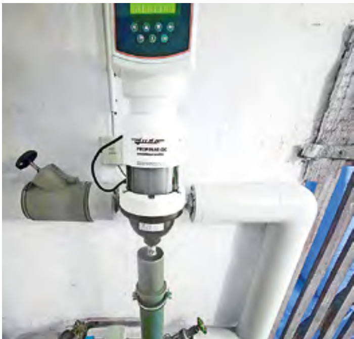
Hier einer unserer modernen Rückspülfilter
