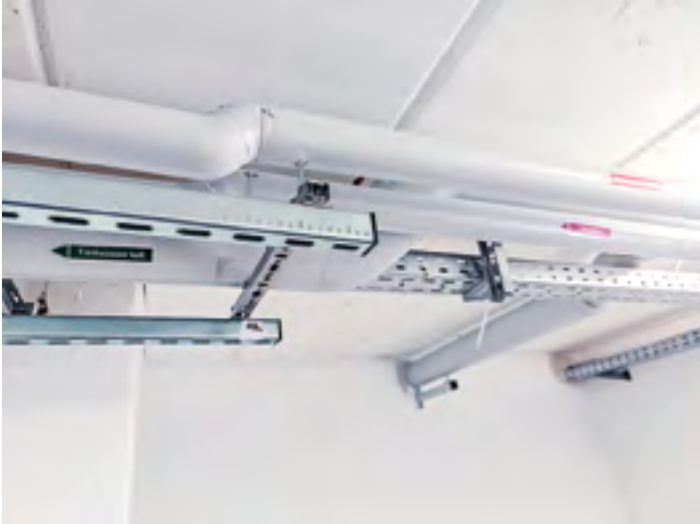
Können sich sehen lassen: Unsere neuen Kellerverteillungen
