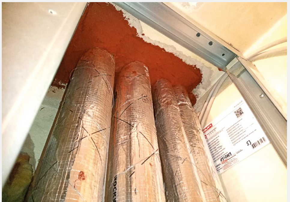
Brandschutztechnischer Verschluss der HLS-Installation in der Deckenebene
